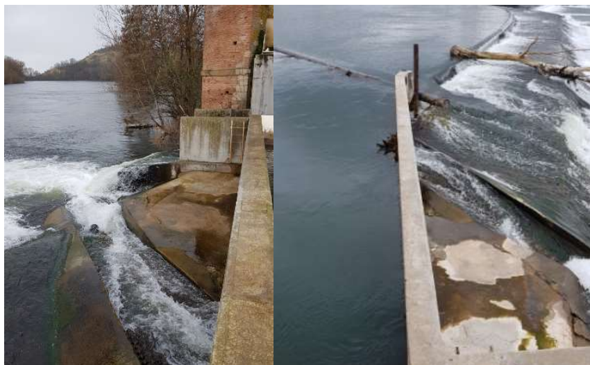
Photos 6 et 7 : Vue de la rampe à plot pour les anguilles.
