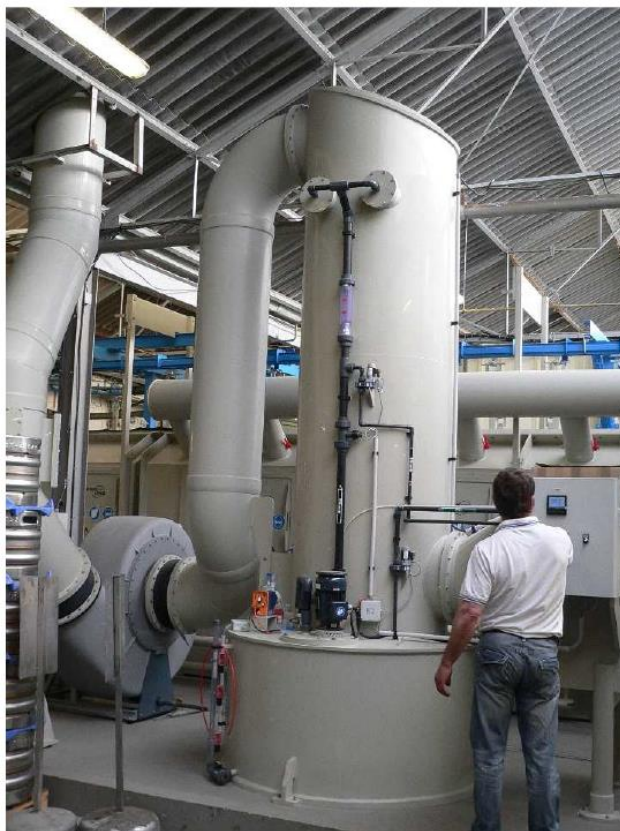
Figure 14 : photographie d'un laveur de gaz (source : Pickling Systems)
